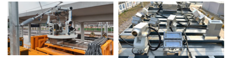
中铁“先锋·四电大模型”在广湛高铁应用
